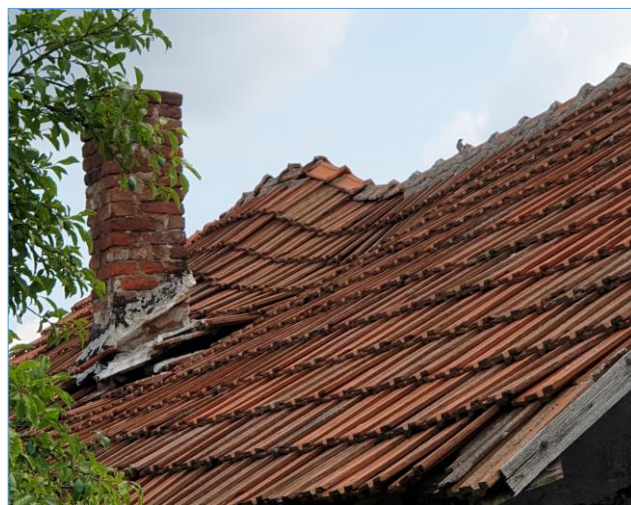
Dak dreigt in te storten
